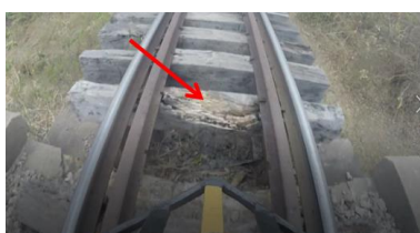
(a) Severidade 0: 1 Dormente estragado
