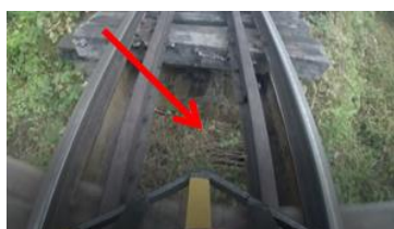
(c) Severidade 2: Dormentes faltando
