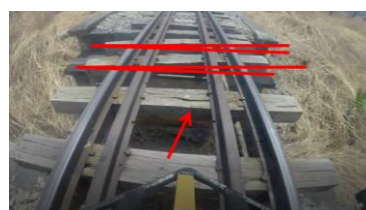
(b) Severidade 1: Dormentes deslocados e dormite rachado
