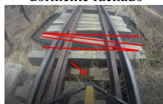
(d) Severidade 3: Dormentes deslocados e faltando
