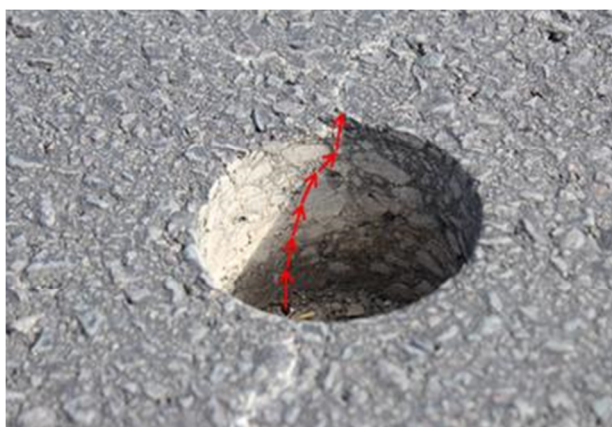
Figura 7: Evidência de que as trincas iniciam de baixo para cima.
