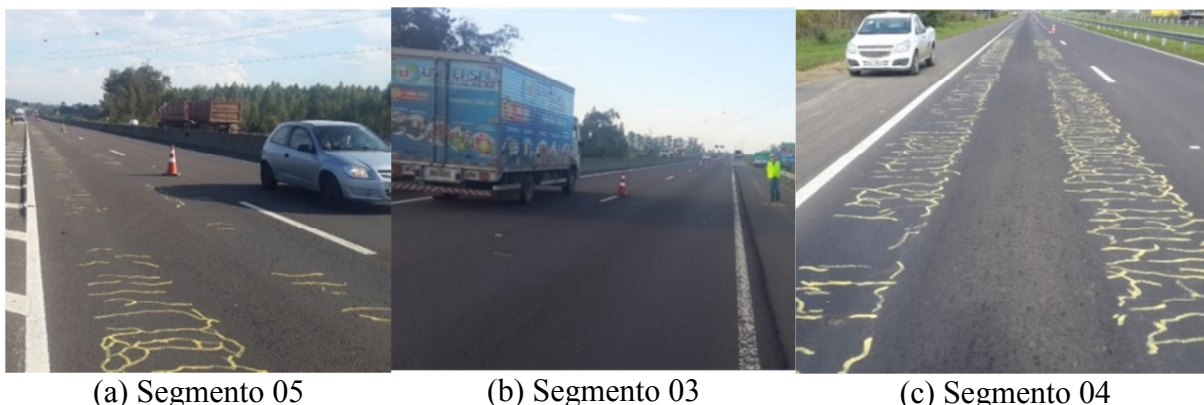
Figura 6: Condições dos segmentos quanto ao trincamento em julho de 2017 (40° mês).
