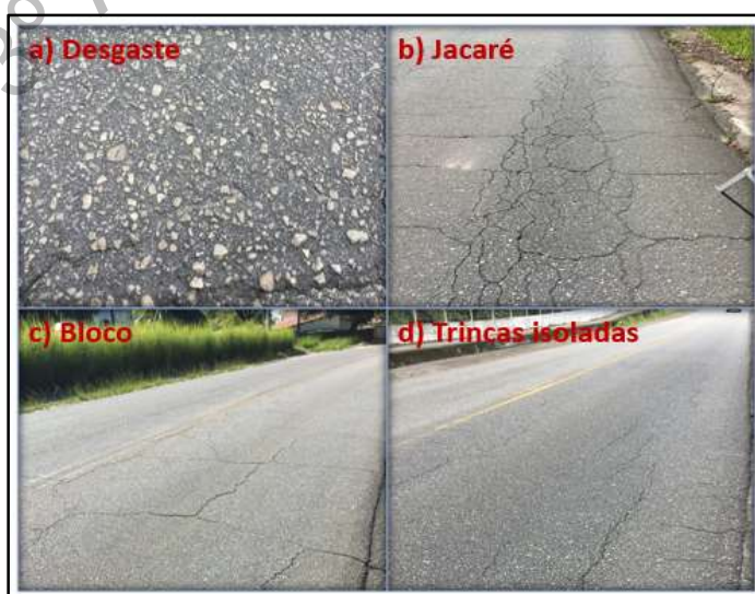
Figura 4: Defeitos que prevaleceram na via analisada.
