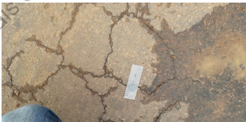
Figura 11: Fissuras tipo jacaré dispostas no trecho – 4.
