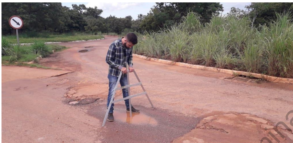
Figura 9: Afundamento e remendos no trecho – 3.
