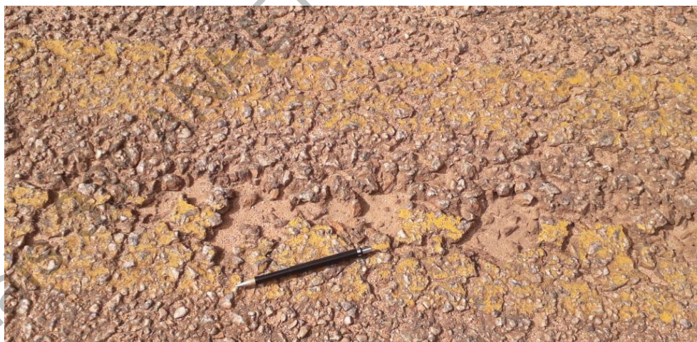
Figura 5: Desgastes superficial e trincas no trecho – 1.
