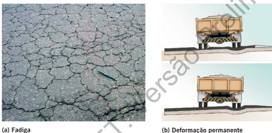
Figura 1: Defeitos estruturais de trincamento e afundamento por repetição de cargas
