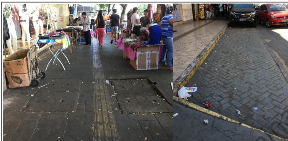
Figura 4: Situação das calçadas em um dos trechos avaliados
