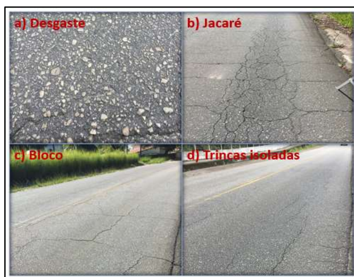
Figura 4: Defeitos que prevaleceram na via analisada.
