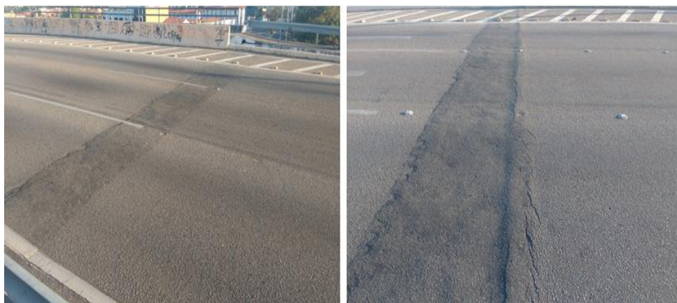
Figura 8: Recalques observados nas cabeceiras dos viadutos
