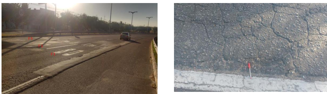
Figura 6: Presença de defeitos no trecho analisado (Duarte, 2018)
