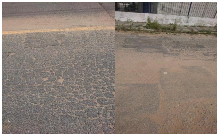
Figura 4: Fissuras e reparações
