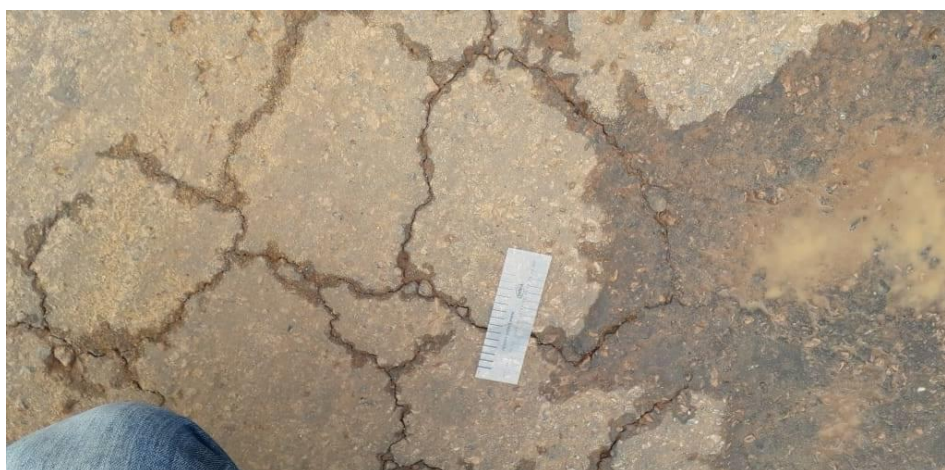
Figura 11: Fissuras tipo jacaré dispostas no trecho – 4.
