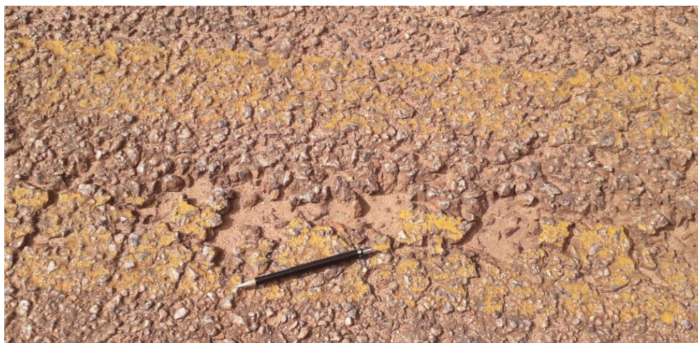
Figura 5: Desgastes superficial e trincas no trecho – 1.
