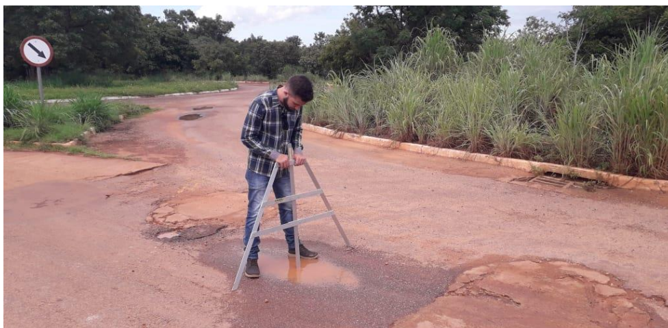
Figura 9: Afundamento e remendos no trecho – 3.
