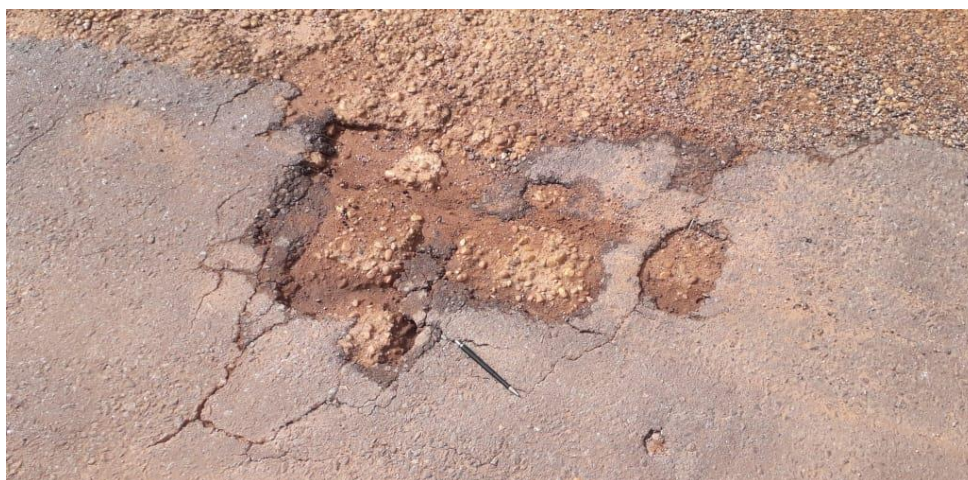
Figura 7: Desgaste superficial, trincas e surgimento de panelas no trecho – 2.
