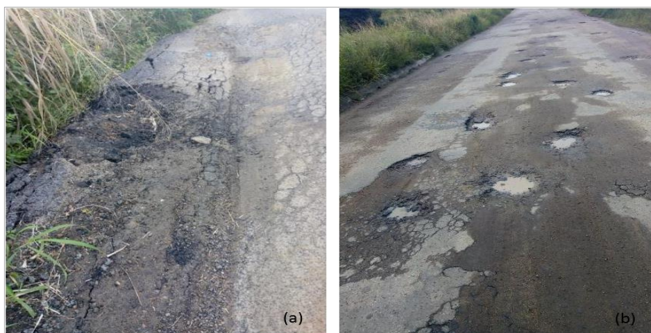
Figura 6: Defeitos encontrados nos trechos analisados, Elevação, panela e trincas do subtrecho 4 do trecho 1 (a), Panelas do subtrecho 1 do trecho 2 (b) (Autor, 2018)
