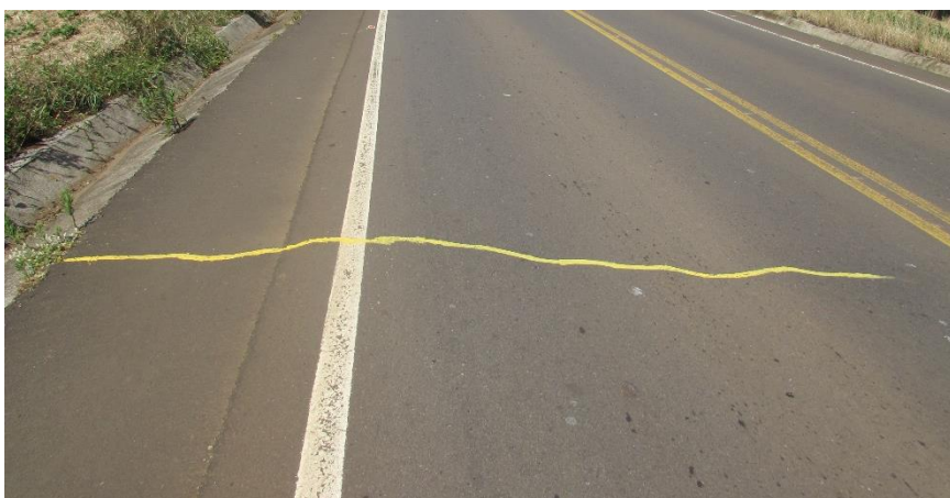
Figura 3: Exemplo de trinca transversal longa, localizada na estaca 2+591 m, sentido BR-153 – BR-282
