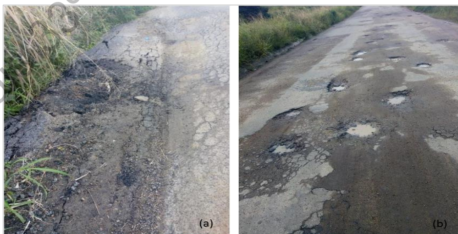
Figura 6: Defeitos encontrados nos trechos analisados, Elevação, panela e trincas do subtrecho 4 do trecho 1 (a), Panelas do subtrecho 1 do trecho 2 (b) (Autor, 2018)
